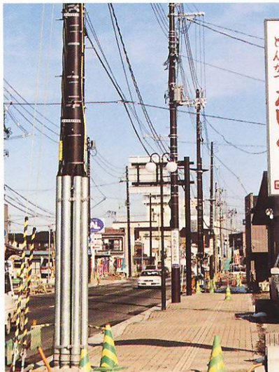
着色された電柱
