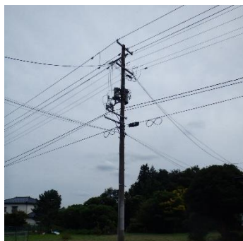
光ケーブル（架空配線）
