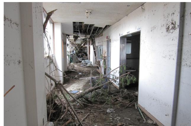
被災した校舎内部(農業高等学校)
