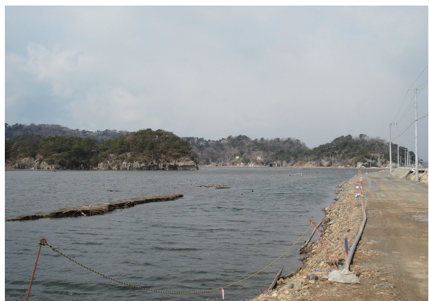
宮戸地区農地海岸の被害状況（東松島市）
