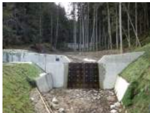
写真-1 溪床の安定を図る治山ダム
