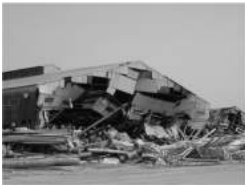
写真-2 合板工場の被害
