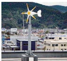
鳥避け用風力発電設備
