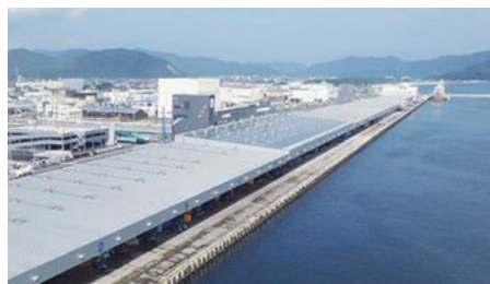
石巻魚市場の屋根に設置された太陽光発電設備
