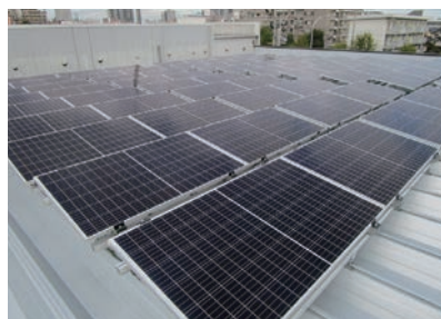
屋根上に設置された太陽光パネル
