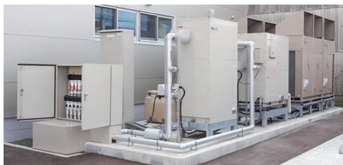
地中熱ヒートポンプシステム
