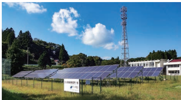
住宅に隣接する発電所には非常時に外部電源の供給ができるよう自立電源を配置しています!
