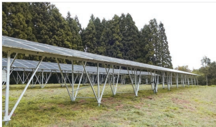
牧草地の上に設置された太陽光パネル
