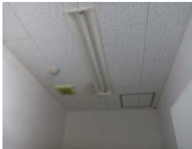
更衣室の天井の漏水痕
