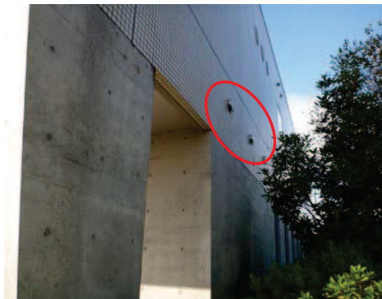
外壁側に換気用のカバーが取り付けられている。
