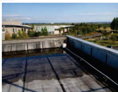
屋上防水の劣化。内部に守りしています。
