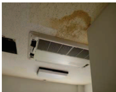
雨漏りに伴う天井材の劣化。B判定
