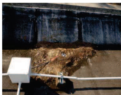
ドレン周りの草や土の滞積。定期的な清掃が必
