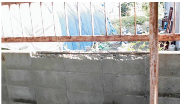
↑ 南側隣地境界ブロック塀 鉄筋露出部分
