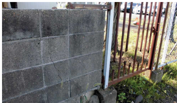
↑ 東側道路境界ブロック塀 ひび割れ部分(ひび割れ幅=1.7mm)
