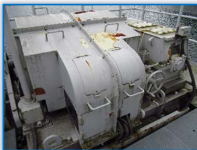
ゲート設備の老朽化
