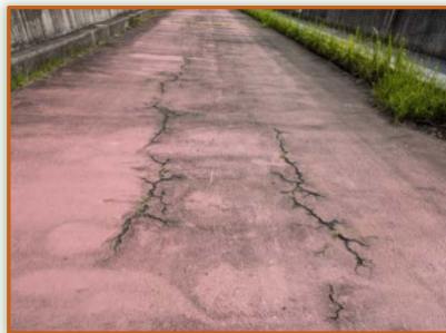
ダム天端舗装面の劣化
