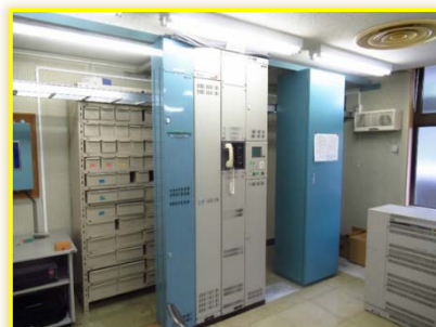
通信設備の老朽化
