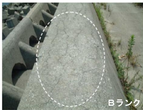
複数方向に幅数 mm 程度のひび割れ
