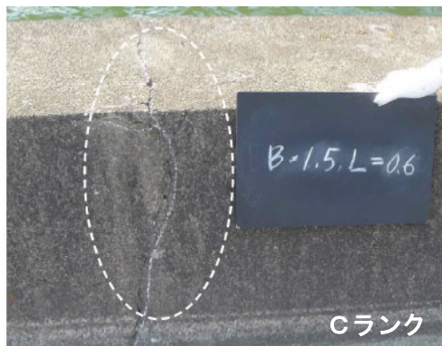
1 方向に幅数 mm 程度のひび割れ
