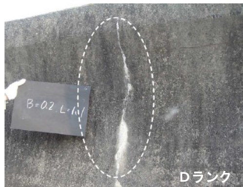
1 mm 程度のひび割れかひび割れが生じていない
