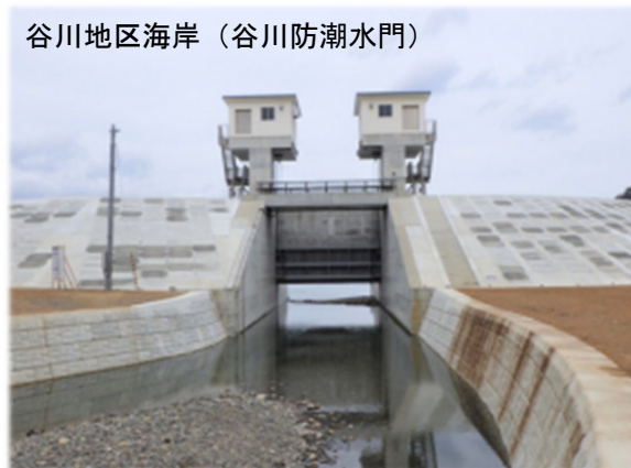
地区海岸 一般点検設備を含む一定区間 土木構造物 部分:C 設備部分:Δ1 堤防・護岸等 健全度評価 D 総合的健全度評価 B* 簡易点検設備を含む一定区間 土木構造物 部分:C 設備部分:○ 健全度評価 C* 総合的健全度評価
