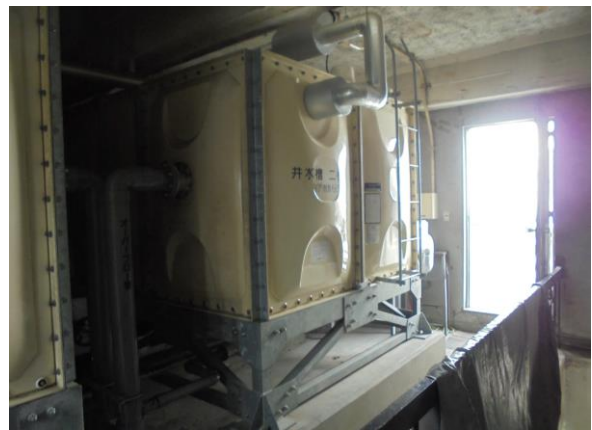
高架水槽(井水)
