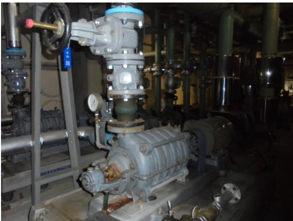
揚水ポンプ(市水)
