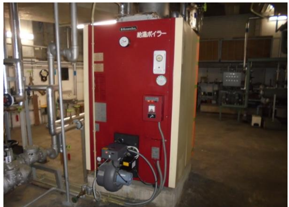
給湯用ボイラー
