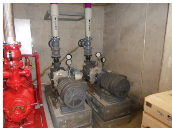
揚水ポンプ(井水)
