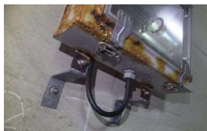
図4-4 健全度Ⅲの損傷例(附属物)
