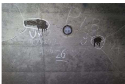
図4-3 健全度Ⅲの損傷例(トンネル本体)
