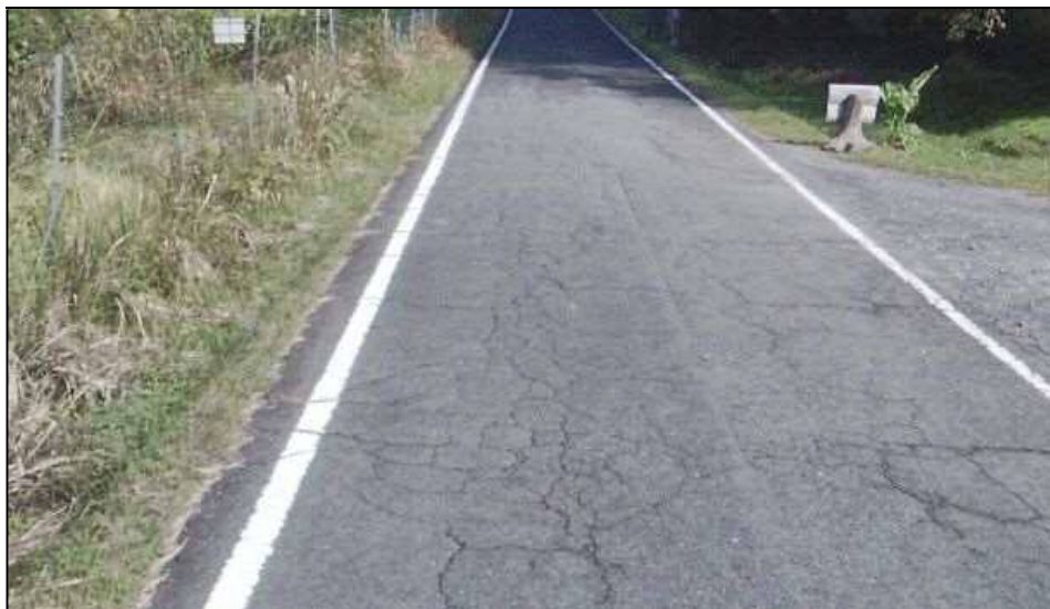
写真-3.3.4 MCI : 2 の路面の例（ひび割れ率：70%、わだち掘れ量：10mm）
