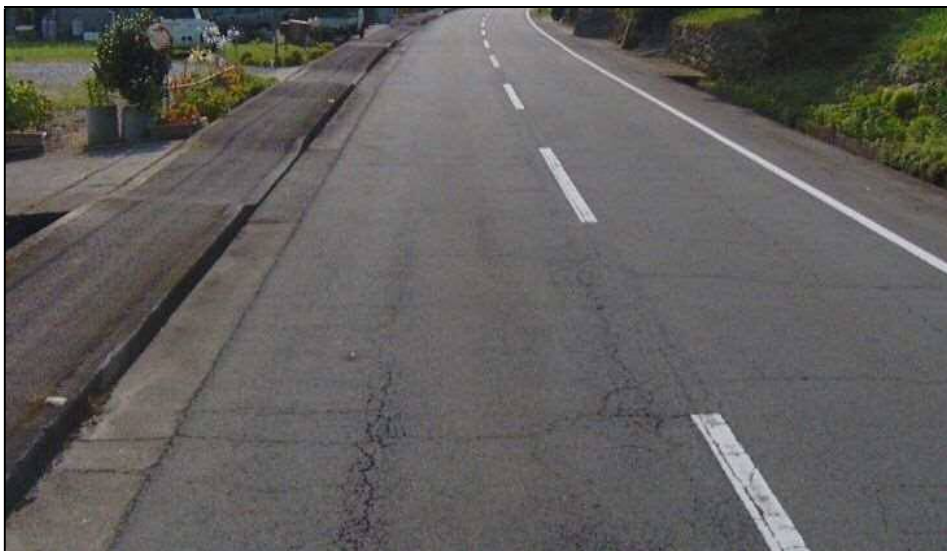
写真-3.3.2 MCI : 4 の路面の例（ひび割れ率:27%、わだち掘れ量:6mm）
