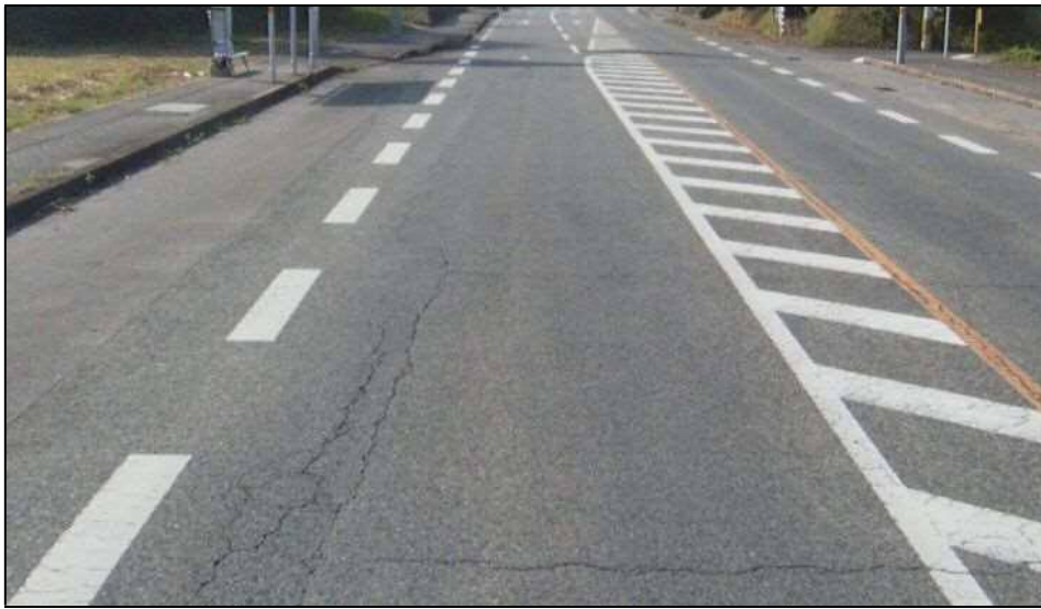
写真-3.3.1 MCI : 5 の路面の例（ひび割れ率:14%、わだち掘れ:9mm）
