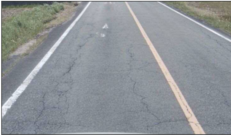
写真-3.3.3 MCI : 3 の路面の例（ひび割れ率:45%、わだち掘れ量:12mm）
