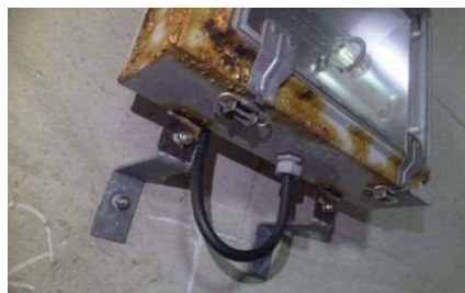
図4-4 健全度Ⅲの損傷例(附属物)
