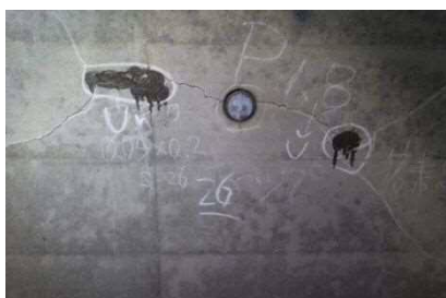
図4-3 健全度Ⅲの損傷例(トンネル本体)
