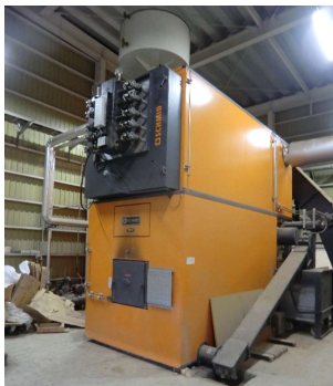
木質バイオマスボイラー
