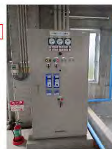
次亜塩素素注入ポンプ現場盤
