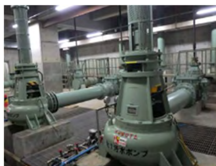
石巻東部浄化センター汚水ポンプ場内部
