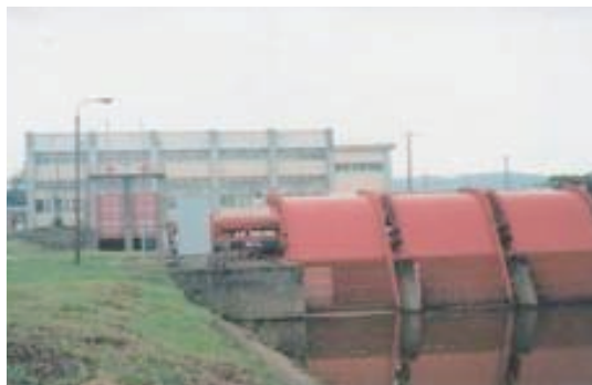
南方揚水機場
