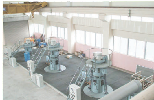
南方揚水機場(機械設備)
