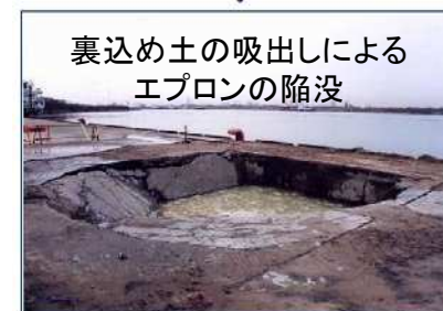
《港湾施設の劣化・損傷事例》
