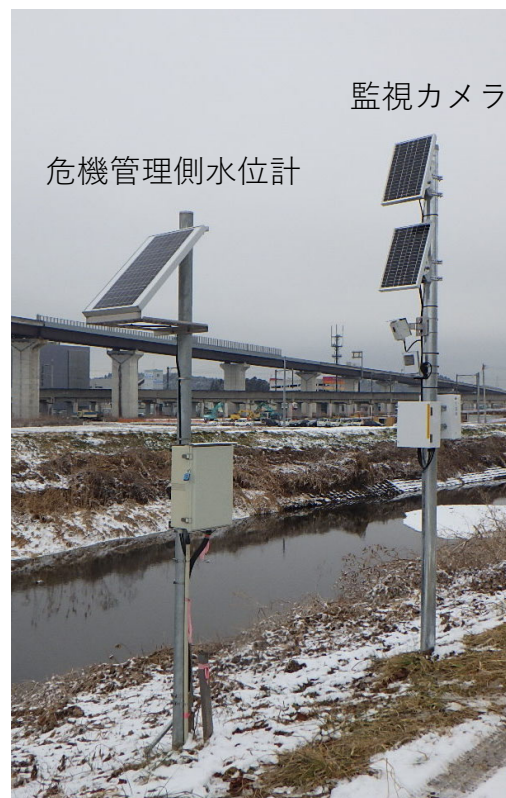
監視カメラ 設置状況（砂押川）
