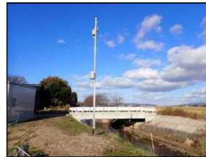
河川監視カメラの整備、改良
