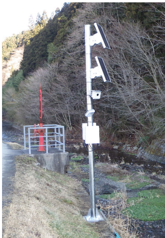
監視カメラ 設置状況(折立川)
