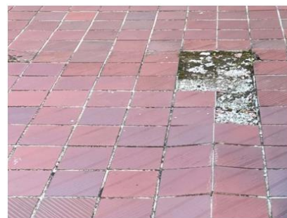
（現状） 中庭の床タイル
