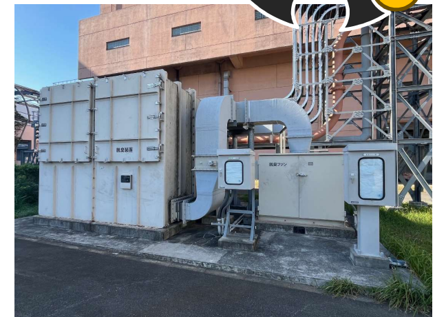
脱臭設備 (類似例)
