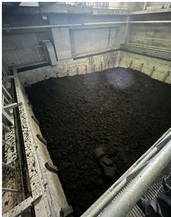
コンクリート製貯留ピット (類似例)
