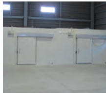
▲冷凍・冷蔵庫
