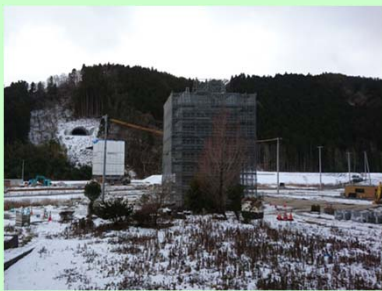
①国道398号相川復興道路事業 ②石巻市北上町十三浜 ③道路改良及び橋梁を施工中 ④47%
