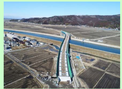
①国道398号石巻バイパスⅡ期工事 ②石巻市大瓜地内 ③真野川橋梁、大和田川橋梁の床版を工施工中 ④90%
