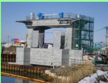
①定川災害復旧工事 ②東松島市大曲地内外 ③大曲関の内地区で護岸工を施工中 ④91%
