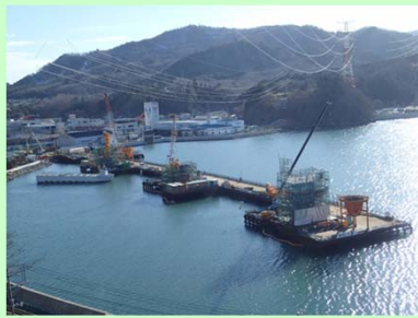
①浦宿道路改良工事 ②女川町浦宿浜地内 ③浦宿地区で橋梁下部工を施工中 ④52%
