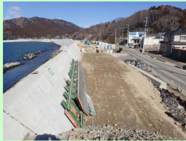
①大原地区海岸災害復旧工事 ②石巻市大原浜地先 ③大原地区で裏法基礎工を施工中 ④78%
