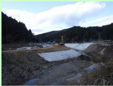
①相川沢川災害復旧工事 ②石巻市北上町十三浜字相川地内 ③右岸で築堤工事を施工中 ④62%
