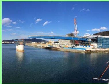
①国道398号内海橋災害復旧工事 ②石巻市中央地内 ③上部工送り出し施工中 ④58%
