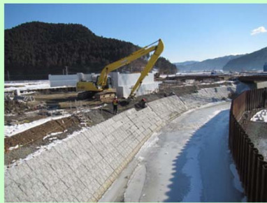
①中島川外河川災害復旧工事 ②石巻市中島字石湊地内外 ③中島川背割堤で護岸工事を施工中 ④55%
