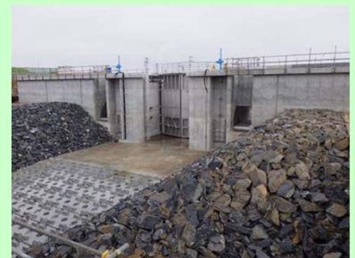
①北北上運河災害復旧工事 ②石巻市蛇田地内外 ③門脇地区で護岸工を施工中 ④81%
