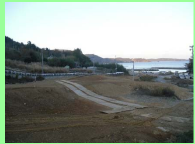
①高白復興道路工事 ②女川町高白浜地内 ③高白地区で路体盛土工を施工中 ④46%
