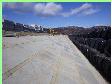
①横須賀地区海岸災害復旧工事 ②石巻市長面地内 ③築堤工事及び護岸工を施工中 ④68%
