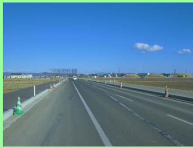
①大曲道路災害復旧工事 ②東松島市大曲地内 ③大曲地区で切り回し道路を施工中 ④30%
