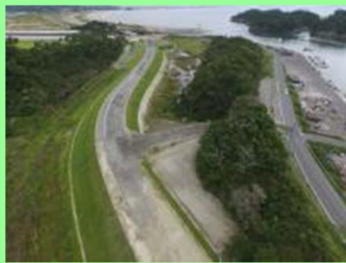
①宮戸道路改良工事 ②東松島市宮戸地内 ③宮戸地区で路床盛土を施工中 ④45%
