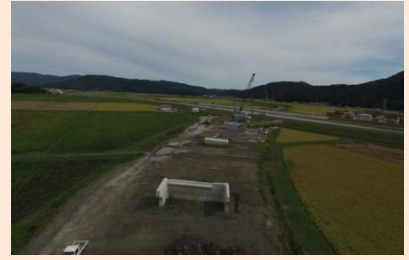
①国道398号石巻バイパスⅡ期工事 ②石巻市大瓜地内 ③八津川橋梁・真野川橋梁・大和田川橋梁の下部工を施工中 ④72%
