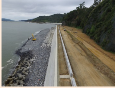
①白浜地区海岸災害復旧工事 ②石巻市北上町白浜 ③コンクリートブロック据付け ④58%
