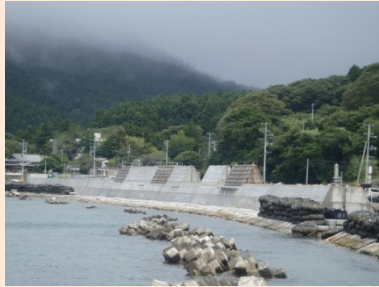
①大原地区海岸災害復旧工事 ②石巻市大原浜地先 ③旧堤取壊し、新堤の堤体コンクリート工施工中 ④36%
