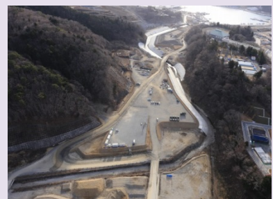
①女川災害復旧工事 ②女川町女川浜地内 ③上清水橋付近の護岸工を施工中 ④60%
