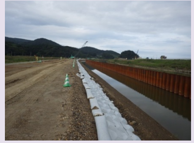
①追波沢川外災害復旧工事 ②石巻市北上町十三浜字江川地内外 ③大沢川で護岸工を施工中 ④10%
