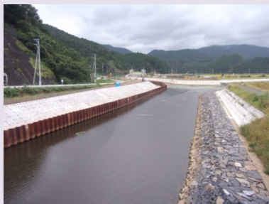
①富士川外1河川災害復旧工事 ②石巻市針岡地内外 ③針岡地区で築堤工事及び護岸工を施工中 ④64%
