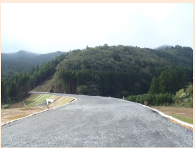
①国道398号御前浜復興道路工事 ②女川町御前浜地内 ③道路土工を施工中 ④61%
