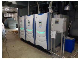
▲事業所における高効率設備(ボイラー)の導入支援
