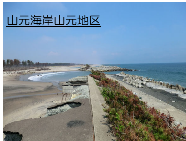
堤防の被災状況(山元町)
