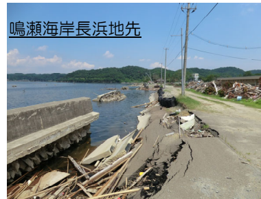
堤防の被災状況(東松島市)
