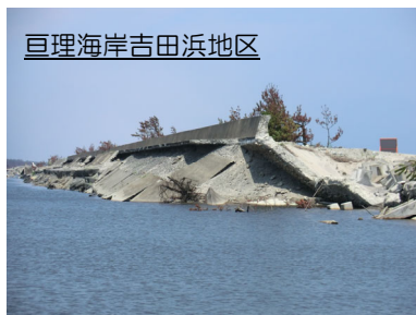
堤防の被災状況(亘理町)
