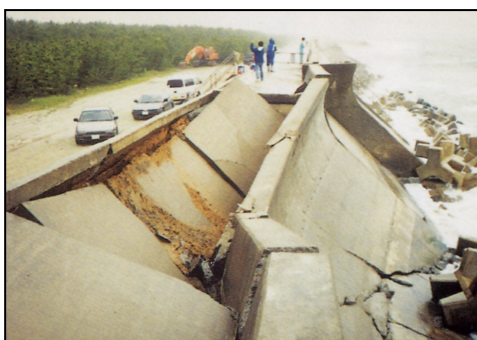
堤防の被災状況（山元町）
