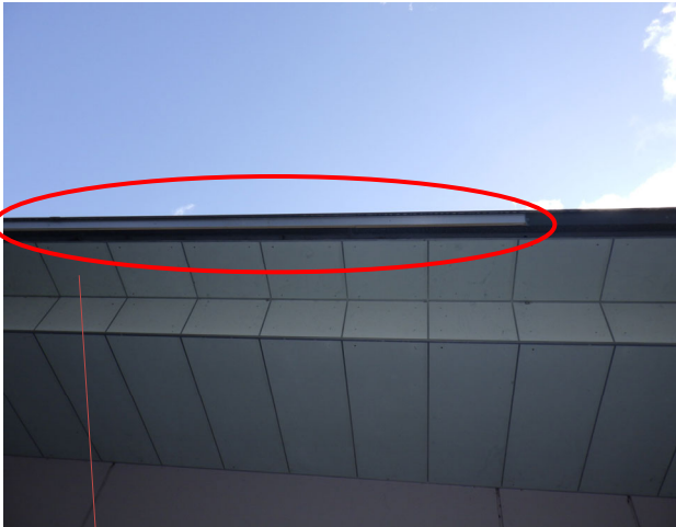
破風が外れて新たに新しく取り付けられている部分があります。
