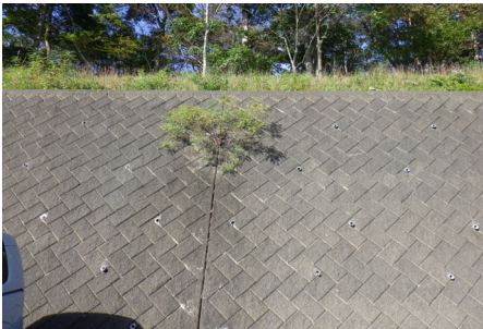
1 敷地及び地盤 間知ブロック積み擁壁目地に雑草が生えています。擁壁にひび割れが見られます。
