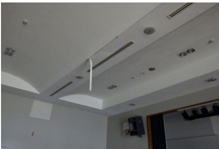
4 内部 天井傾斜部（多目的ホール）の見切り材が一部脱落しています。
