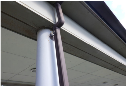
2 外部 渡り廊下 柱等に錆が見られます。
