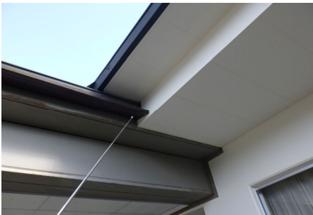
2 外部 渡り廊下 樋の両端が下がっています。
