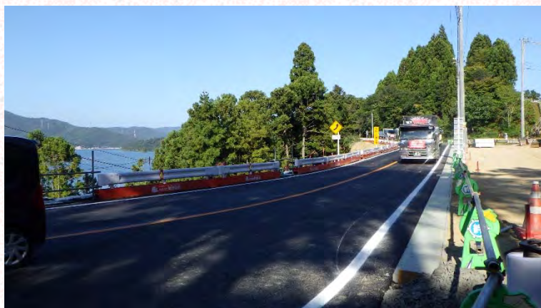
状況写真①
