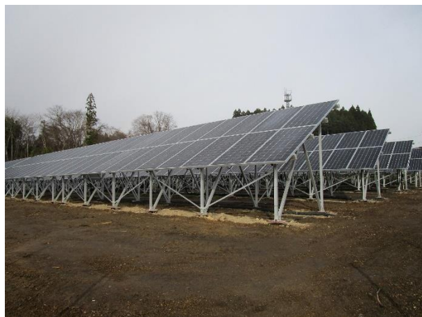
花山第二太陽光発電所 (出力: 950kw)
