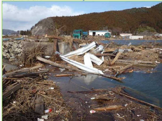
針岡排水機場 2011.6月
