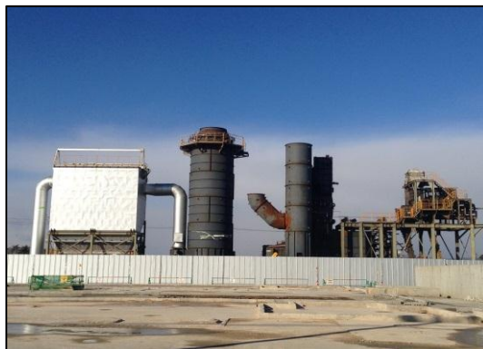
写真11-2 岩沼処理区焼却炉の部分覆い
