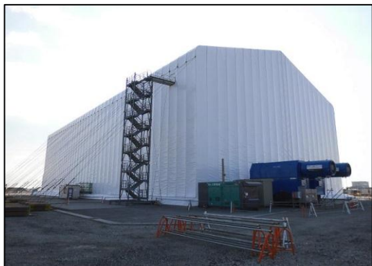
写真11-1 名取処理区焼却炉の全覆い
