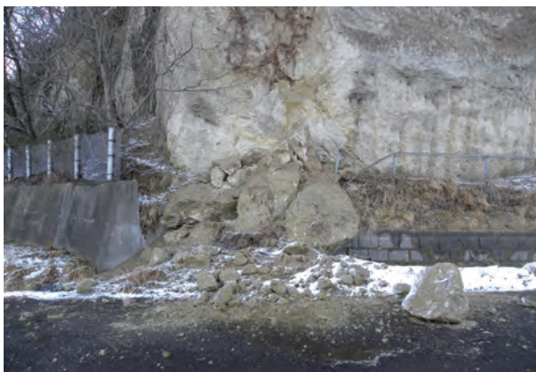
写真3-26 史跡山畑横穴群崖面崩落状況 (1-40)
