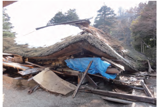
写真5-10 倒壊した主屋
