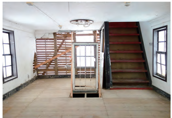
写真5-15 教会堂内部の被害状況
