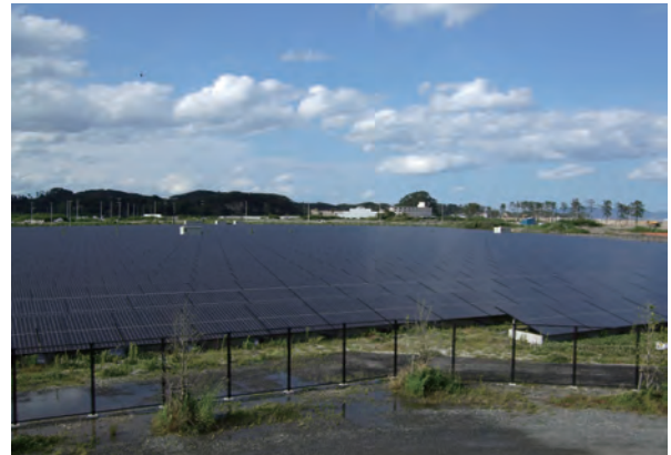
写真7-9 東松島市野蒜海岸のメガソーラー
