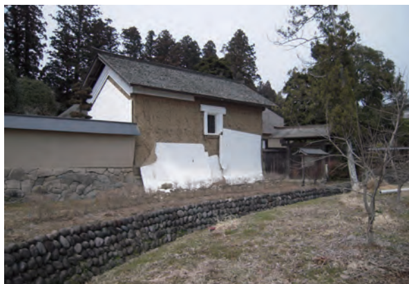
写真2-5 我妻家住宅土壁崩落状況
