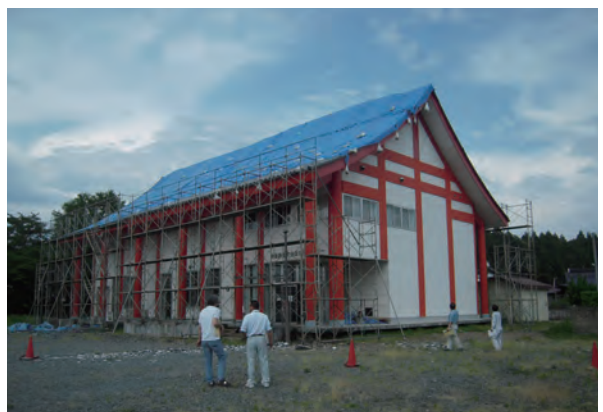
写真3-53 栗原市築館出土文化財管理センター被災状況
