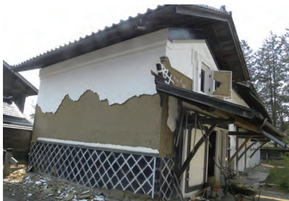
写真2-6 史跡旧有壁宿本陣土壁崩落状況
