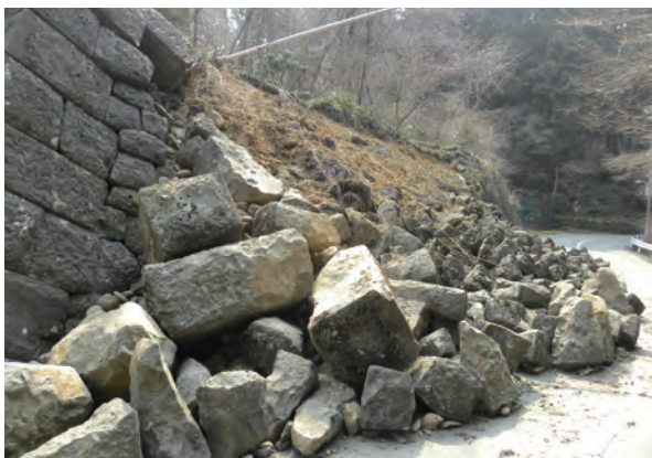
写真5-6 地震により崩落した石垣
