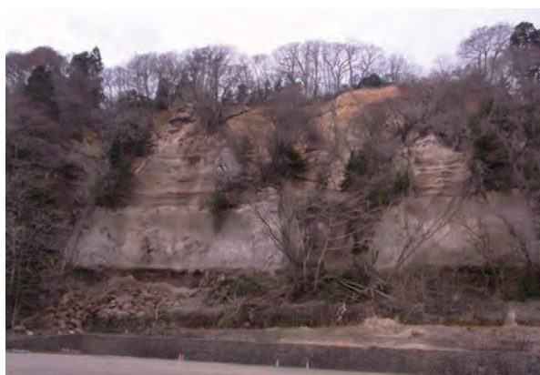
写真2-4 史跡仙台城跡本丸東側崖崩れ
