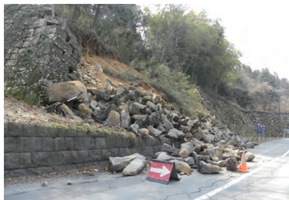
写真2-3 史跡仙台城跡石垣崩落状況
