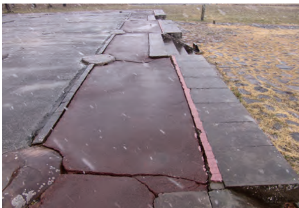
写真3-22 特別史跡多賀城跡附寺跡正殿基壇亀裂 (1-35)
