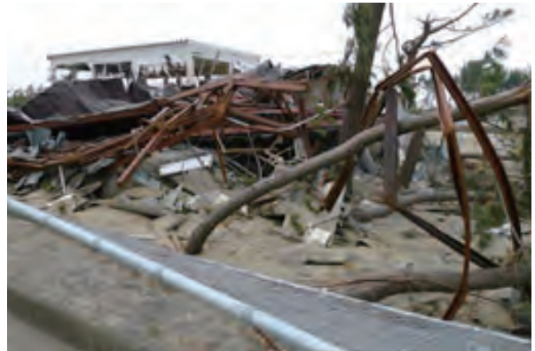
写真3-50 全壊した漁具収蔵施設
