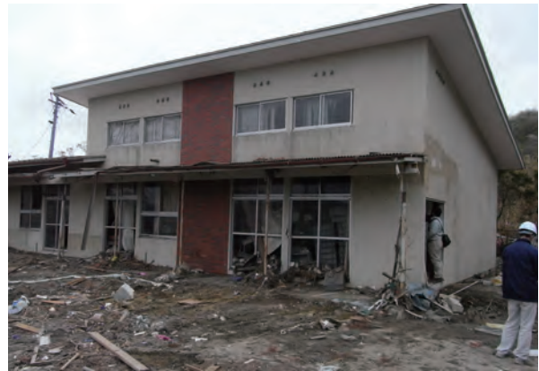
写真3-47 2階まで浸水した野蒜文化財収蔵庫
