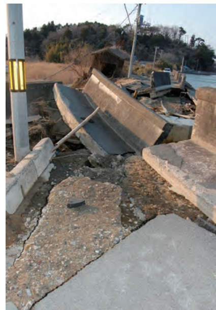
写真3-32 手樽地区の被災状況
