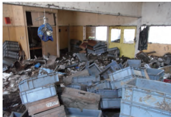
写真3-48 崩落した整理用コンテナ
