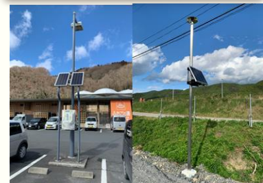
駐車場用街路灯
