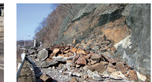
川崎町(がけ崩れが発生した道路)
