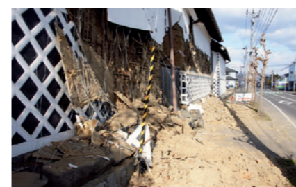
大河原町(崩壊した土倉の壁)
