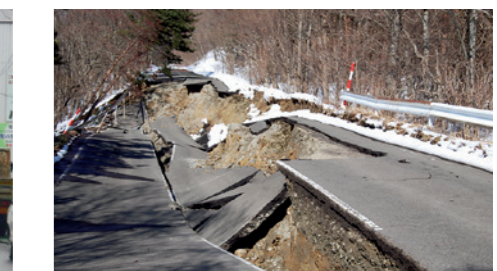
川崎町(崩落した道路)
