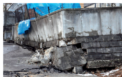
仙台市(崩れた擁壁)
