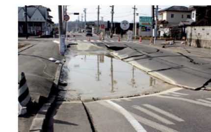
柴田町(陥没した道路)
