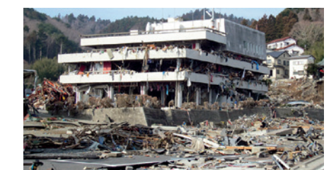
写真:女川町(3階まで浸水した役場庁舎)
