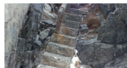
写真: 気仙沼大島遊歩道災害復旧工事(復旧前)
