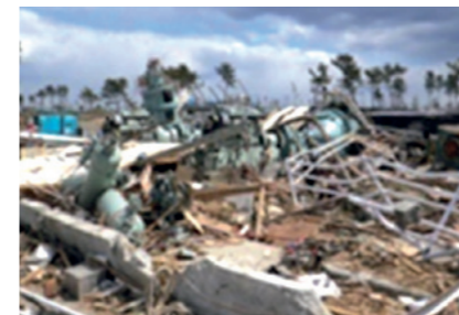
写真:二郷堀排水機場(仙台市)被災状況(平成23年)
