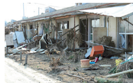
写真:津波被害を受けた市営沼沼住宅(東松島市)
