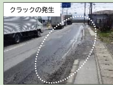
沿岸部の舗装劣化状況
