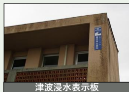
津波浸水表示板
