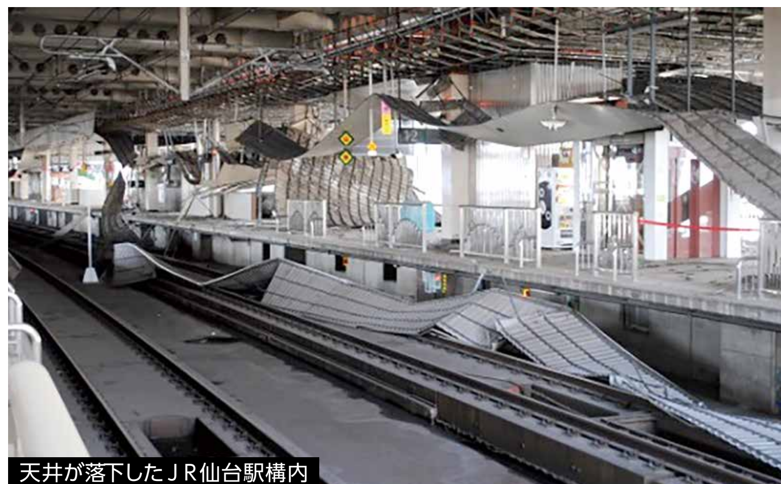
天井が落下したJR仙台駅構内
