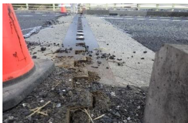
(主) 築館登米線 迫町新田 路面クラック
