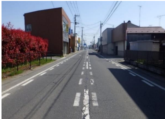
補修前の状況
