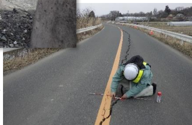
(国) 398号 迫町北方 飯土井大橋 伸縮継手破損
