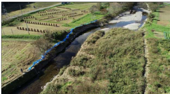
【二股川・被災箇所】
